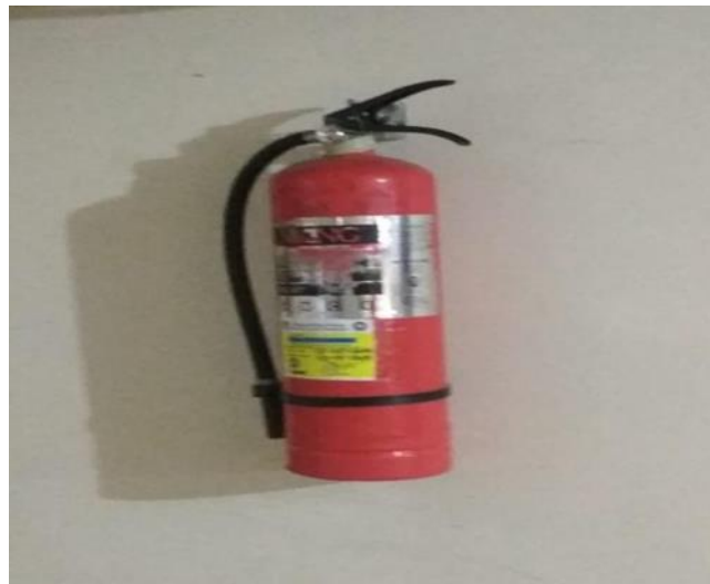
Gambar 32. Alat Pemadam Kebakaran
