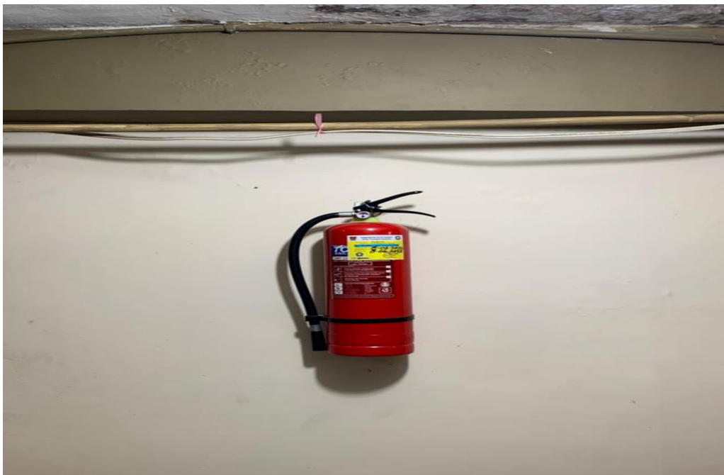
Gambar 37. Alat Pemadam Kebakaran
